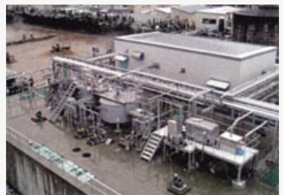
▲ 排水処理設備
